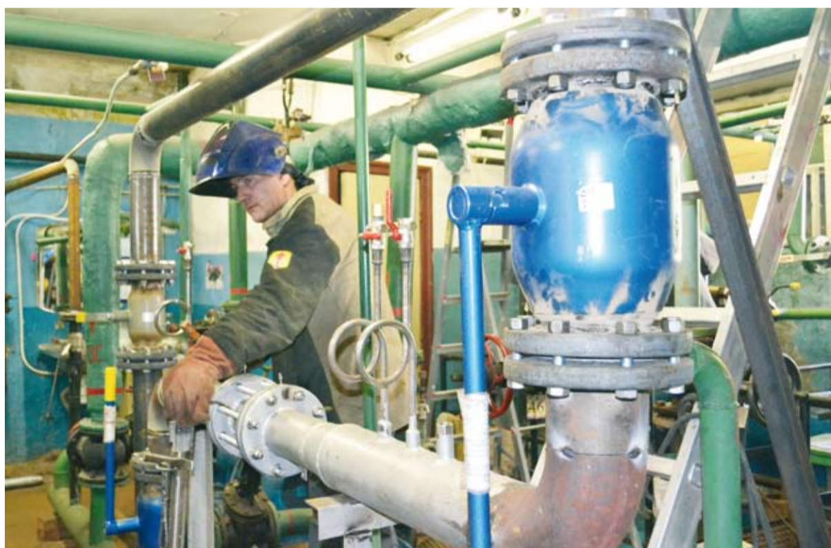
Узлы учета устанавливают и на котельных
