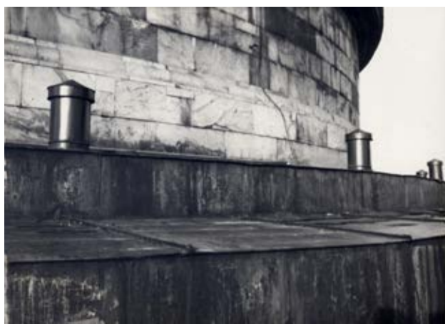
1955 год. Трубы вентиляция Исаакиевского собора. Фото © СПб ГБУК «Государственный музей-памятник «Исаакиевский собор», 2022
