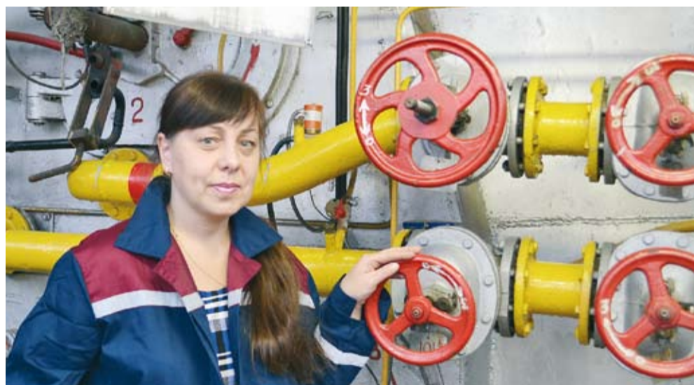
Работники следят за порядком на котельной
