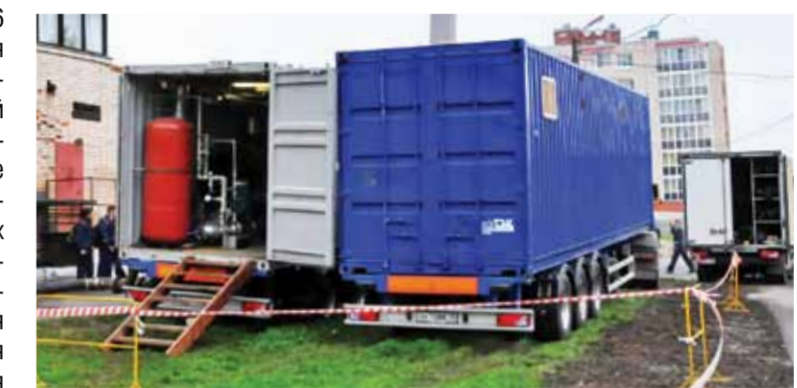
Для отопления детского сада теплогенераторы подключили передвижную блок-модульную котельную.
