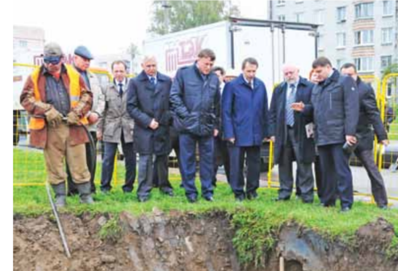
Место технологического повреждения тепломагистрали.
