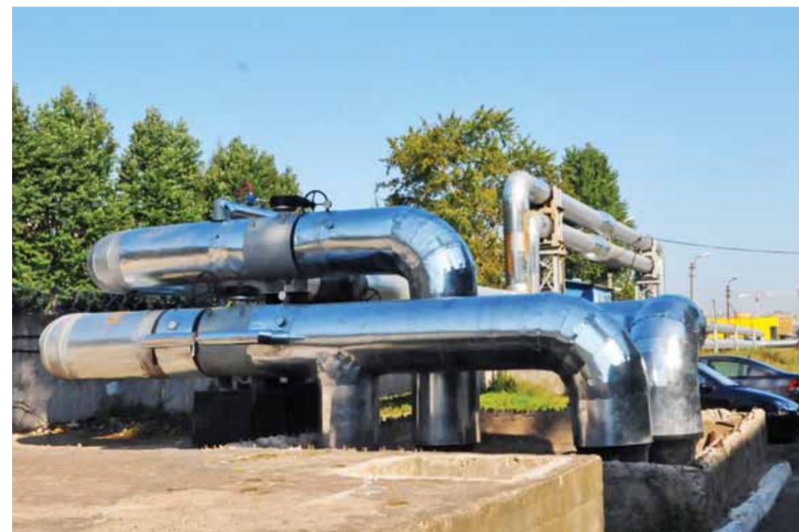
Надземная часть теплотрассы проходит по территории 3-й Красногвардейской котельной.
