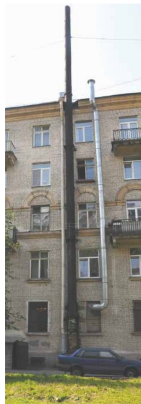
Встроенная котельная на Новочеркасском проспекте
